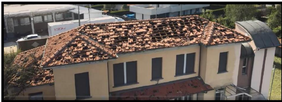
Figura 4: Ingenti danni alle coperture di edifici pubblici e privati in comune di Misinto. Fonte Regione Lombardia.
