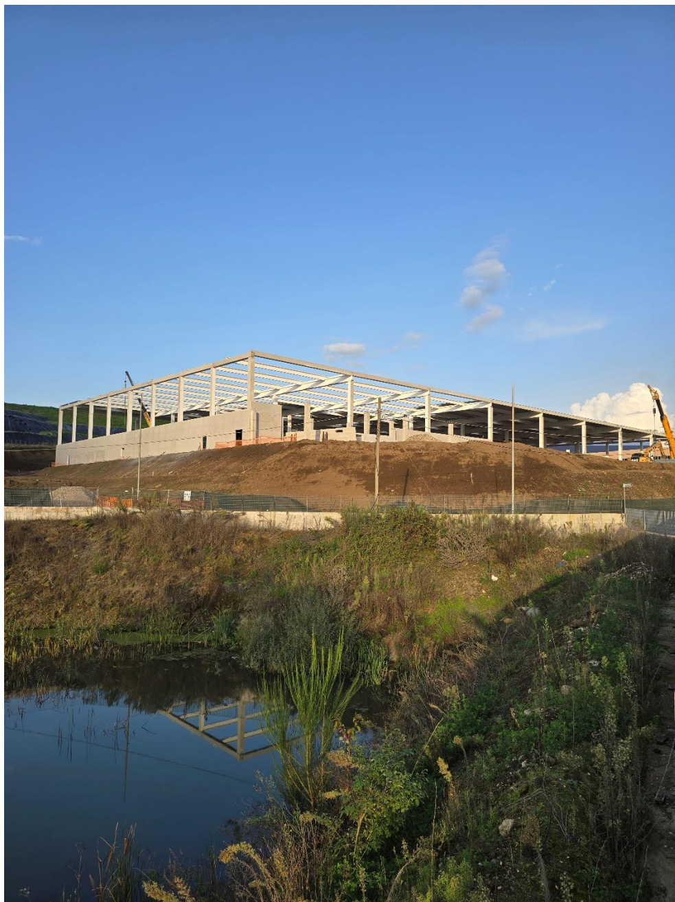
Figura 80. Cantiere nei pressi dell'area industriale di Colferro (Roma). Foto di Isabella Renzi
